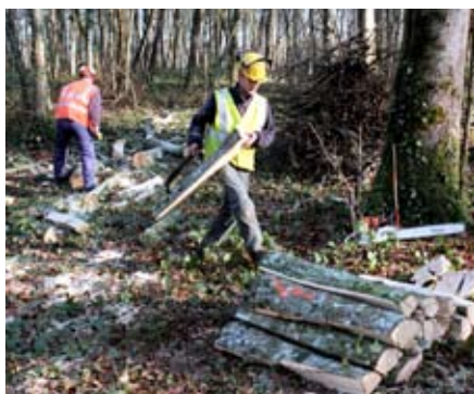
Éviter d'encombrer les voies d'accès au chantier.
